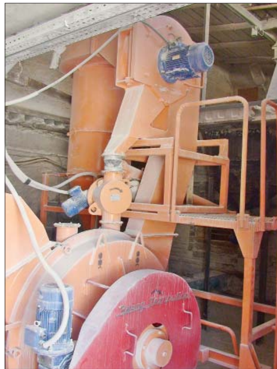
Рис. 3. Ударно-центробежная мельница «ТрибокINETИКА» на ЗАО «ККСМ», 2010 год ввода в эксплуатацию
